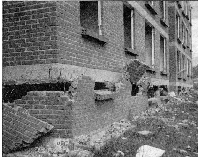
Figura 1.8 Edificio de mampostería reforzada de 4 pisos. Colapso del primer nivel
