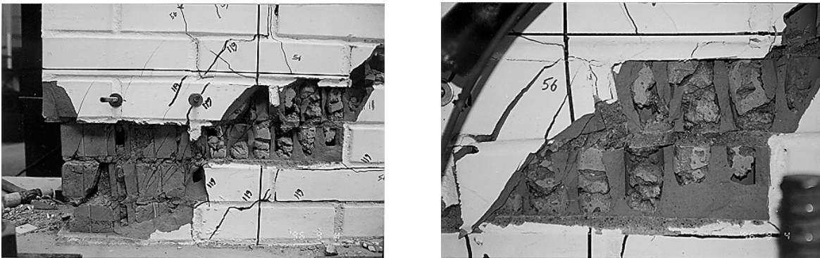
Figura 3.6 - Condición final de daño (castillo Este)
